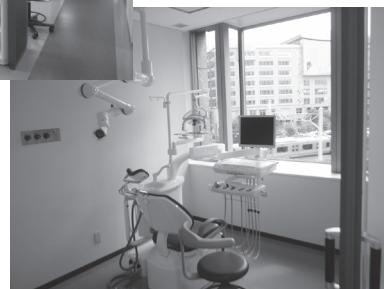
医療ガスユニットを 配備したチェアー
